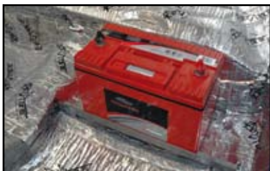
Derrière le siège conducteur, un rack est fixé pour accueillir une grosse batterie Tsunami pour nourrir les 5 amplis de l'installation.
